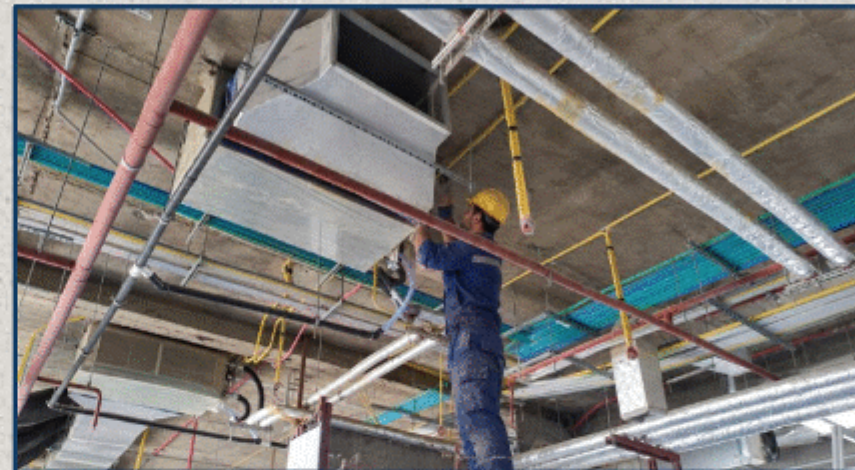
نصب سر دستگاه فن کویل‌ها
